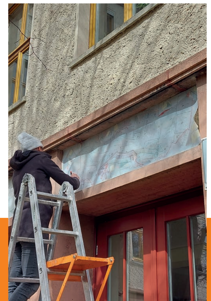
[ r: Während der Abnahme der Fehlstellenbereiche am Salamander ]
