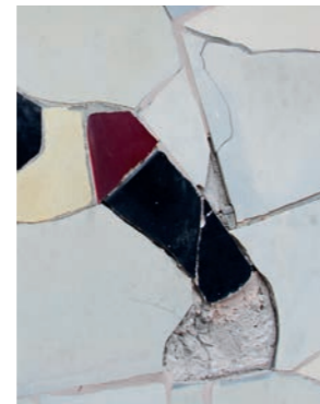
[ Ein Bereich mit lockeren Fliesen ]
